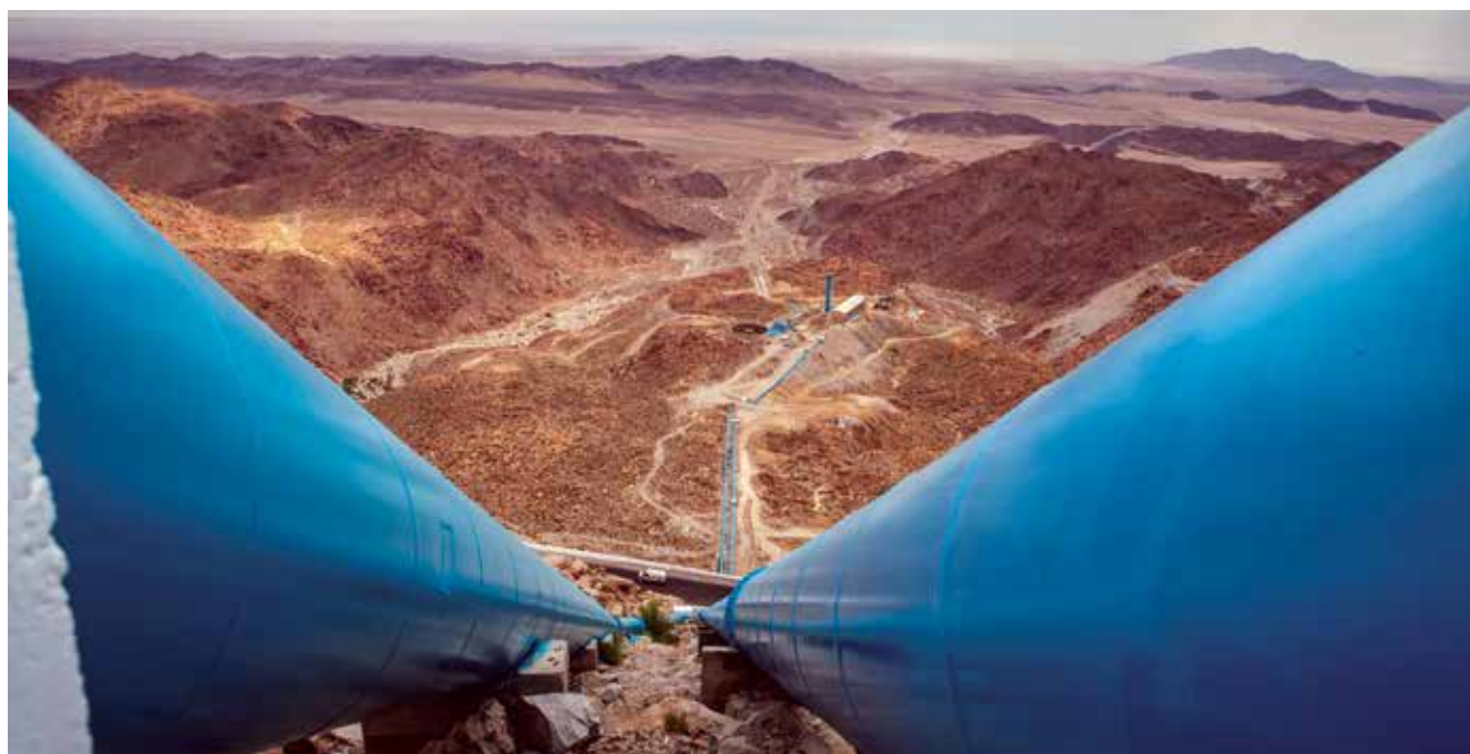
Acueducto Río Colorado en Tijuana, BC, con vista a las plantas de bombeo 5, 4 y 3.
