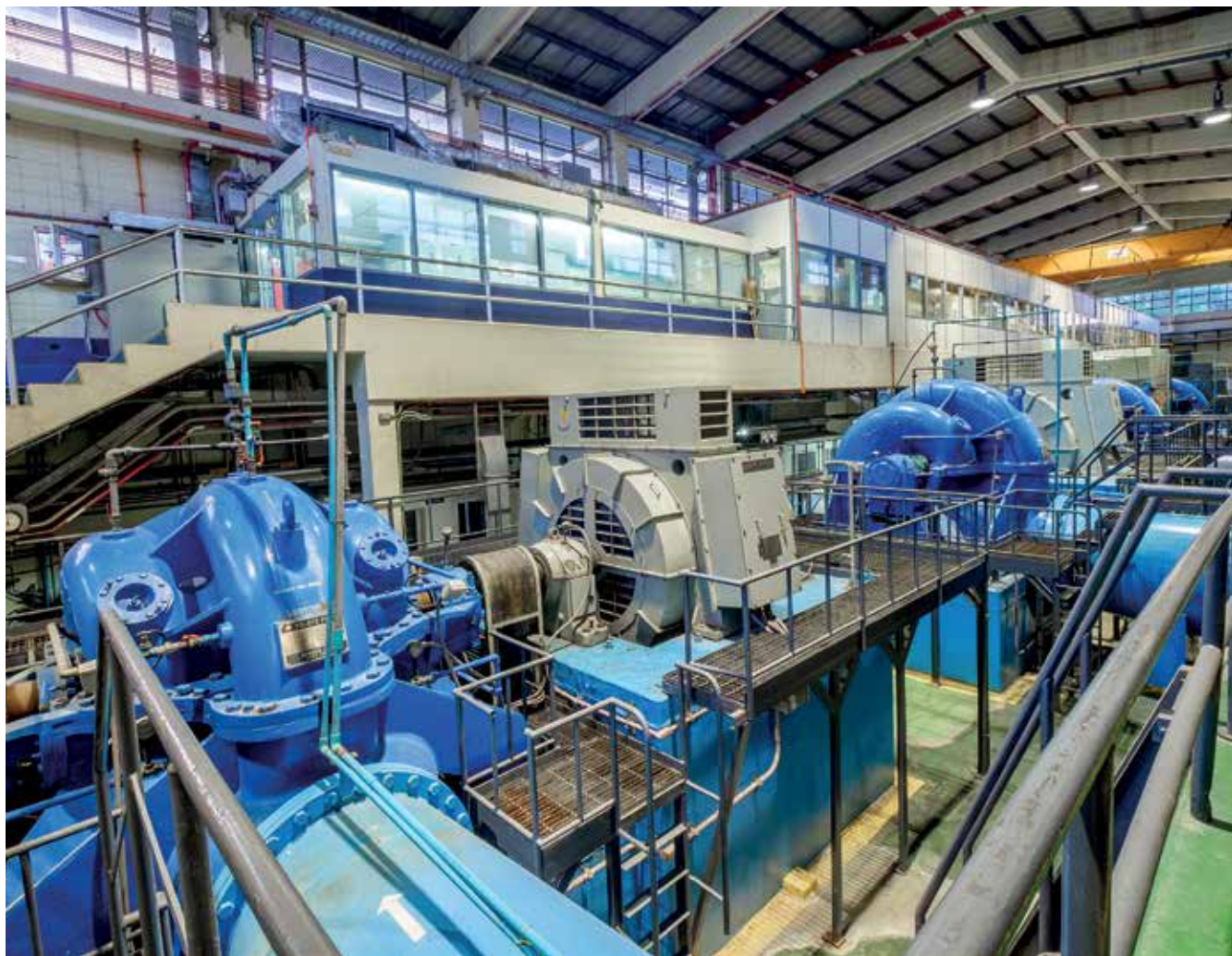
Bombas y motores para bombear el suministro de agua en planta de tratamiento de aguas de Bangkok, Bangkok, Tailandia.
