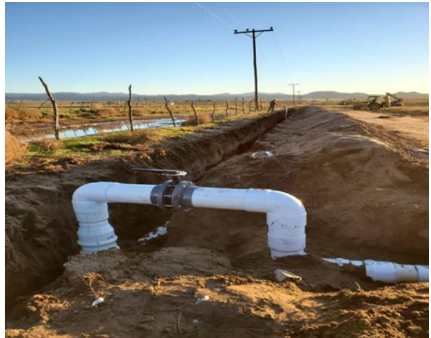
Válvula mariposa instalada
