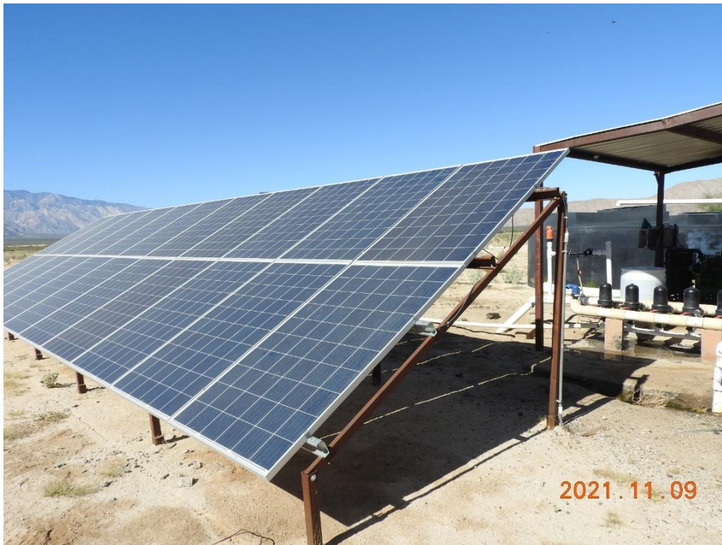
Tecnificación en pozo, equipo fotovoltaico
