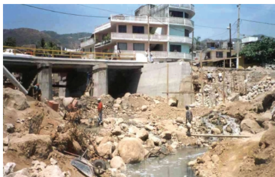
Daños por Huracán Paulina en Acapulco
